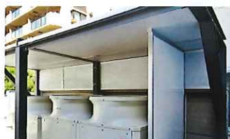
②空調室外機防音壁
